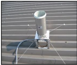
雨量警報装置 15 か所
