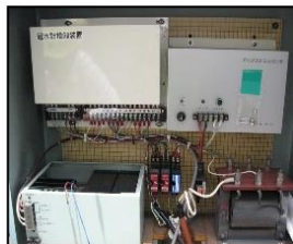
冠水警報装置・3 か所
