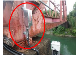
橋梁異状検知装置・3 か所
