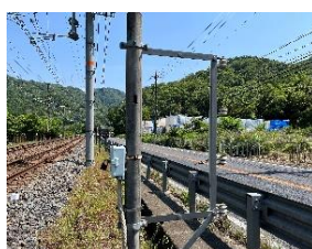
自動車転落警報装置・2 か所
