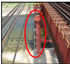
河川水位警報装置・17 か所
