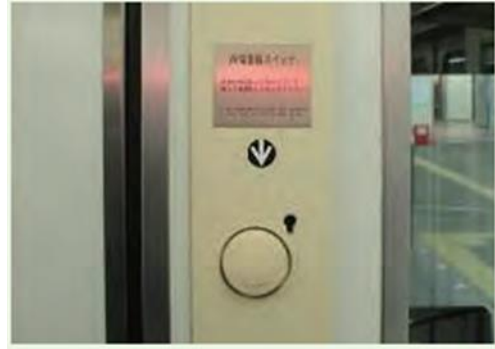
車内非常通報装置
