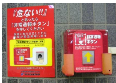
非常通報ボタン
