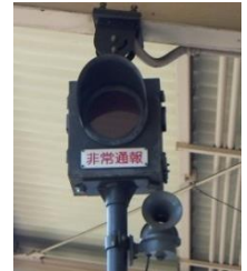
非常通報表示器
