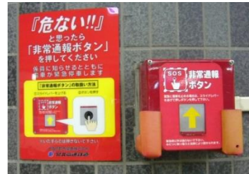
非常通報ボタン
