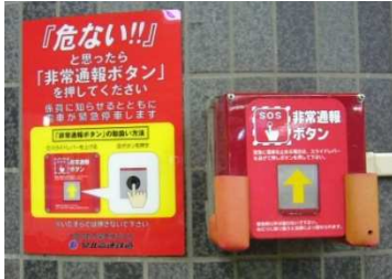
非常通報ボタン
